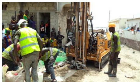
Réalisation de sondages pour les études géotechniques préalables à la construction d'un réseau d'égouts à Saint-Louis (Sénégal).
